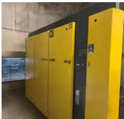
Nuovo compressore a vite lubrificato, potenza da 160 kW con recupero del calore.
